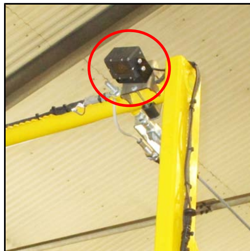
储料仓出口摄像机
