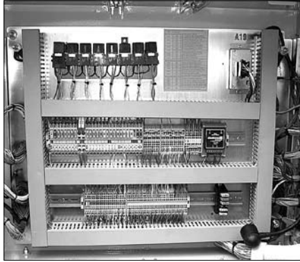
Merkezi elektrik devre panosu
