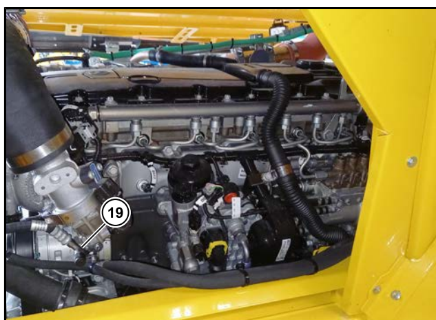
(19) Collegamento di manutenzione sul compressore
