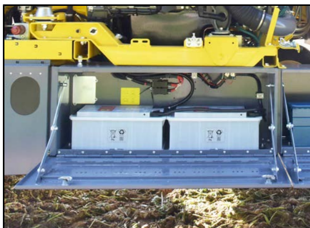
Coffre à batteries
