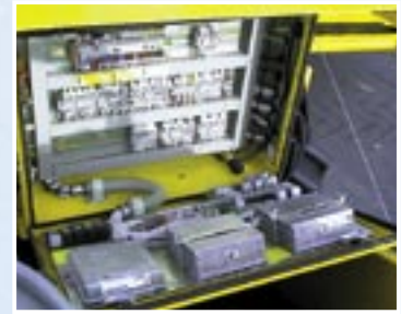
Zentralelektrik m. CAN-Rechner
